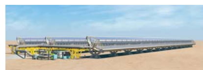
Primo impianto CSP AIRLIGHT ENERGY ad Ait Baha (Marocco)
