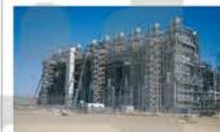
Cinque impianti realizzati da Elex a Saudi Kayan in Saudi Arabia
